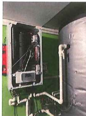
Фото 4 – Электрический котел и теплоаккумулятор
